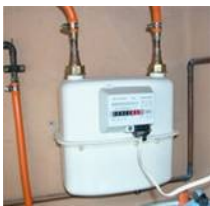
Contador de gas
